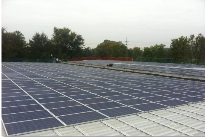
Halle 1 + 2: Dachfläche mit PV-Modulen belegt.
