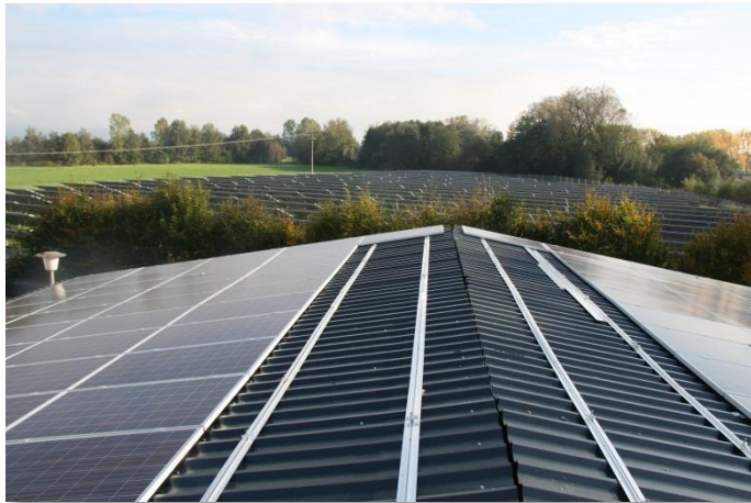
Halle 4: Dachfläche saniert und mit PV-Modulen belegt . Im Hintergrund die EnBW Freiflächen PV Anlage.
